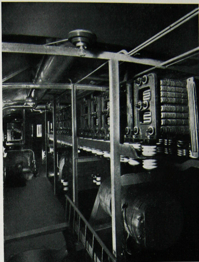
FIG. 8 - CABINA A.T. - VEDUTA D'ASSIEME.
